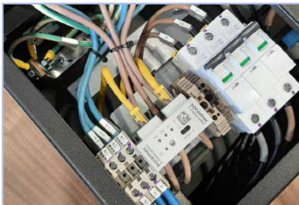
Fig 4. intégration DIRIS Digiware S dans un coffret de dérivation
